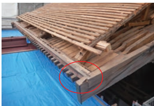
写真16 破風板及び破風板木口 (破風板木口上端が極端に前屈みになる)
