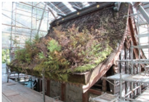
写真5 屋根の破損状況 修理前背面
