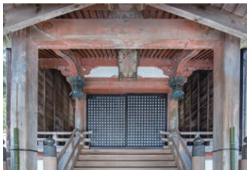
写真12 正面格子戸の防塵対策 (パネル取付)
