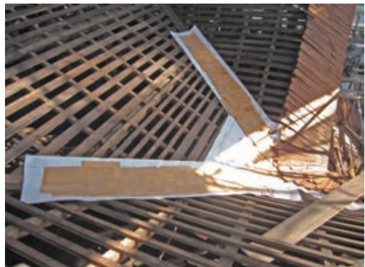
写真12 同前 施工状況 谷部の漏水対策範囲を広げ、 土居葺下にルーフィングを敷く
