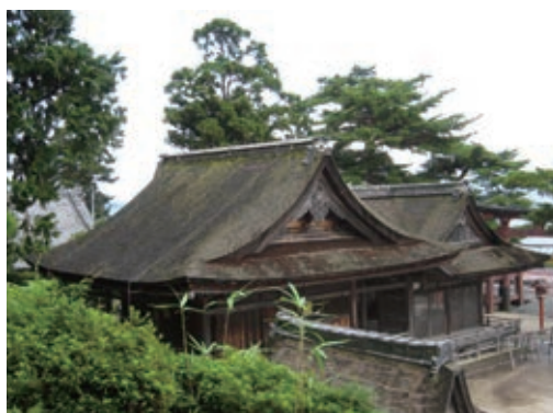
写真2 修理前 本殿背側面 苔が全面に付着、西面は下軒付の痩せが著しい
