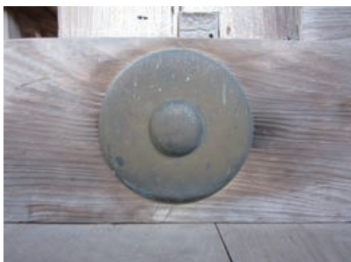
写真8 修理前 縁長押 箱押しの剥落
