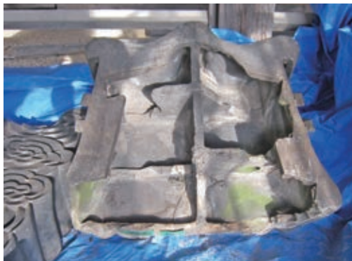
写真6 修理前 獅子口背面 箱棟を差し込む部分に合わせて 割られたリブや背面の蓋
