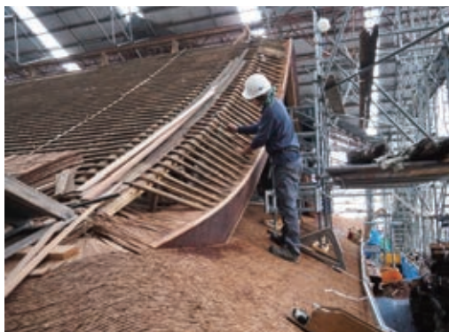
写真16 施工中 本殿 葺甲下地、櫛形板ではなく、 野木舞状の部材を葺甲上に掛ける
