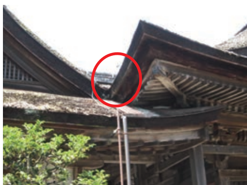
写真4 修理前 本殿と拝殿の取合い部分 本殿側の軒付に腐朽（中央の丸）
