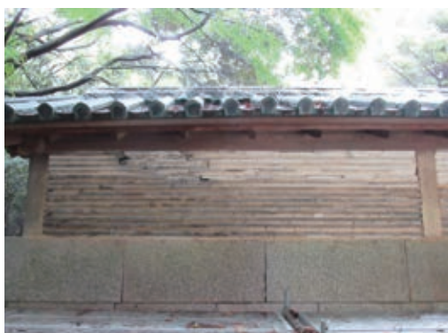
写真3 築地塀斗瓦の破損（修理前）
