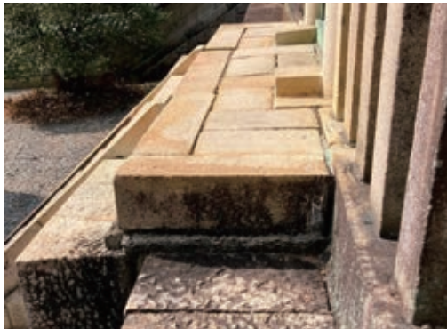
写真2 唐門前石敷の不陸（修理前）
