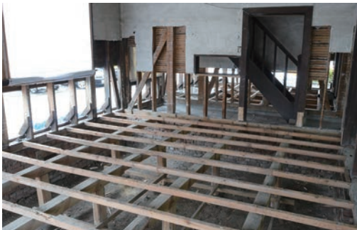
写真5 修理前1階床組（会議室1）
