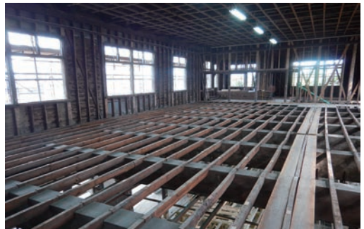
写真6 修理前2階床組（ホール）
