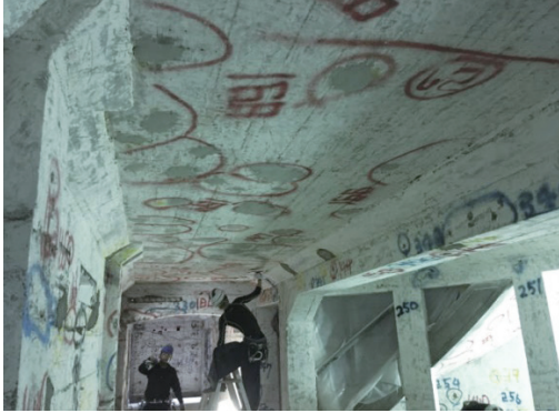
図1 躯体劣化部マーキング状況（地階廊下）
