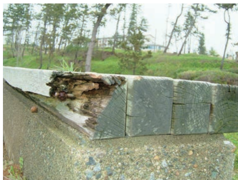
写真1-2 外構施設に利用されていたヒバの部材（辺材を含んでいた部材ではその部分だけが腐朽）
