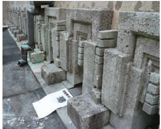
3階和室底上 擬石飾りAタイプ状況 表面劣化や欠損が見られる
