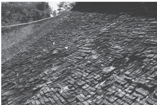
図6 身舎こけら葺破損状況
