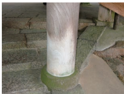
写真4-1 石との接触部からの柱の白化現象
