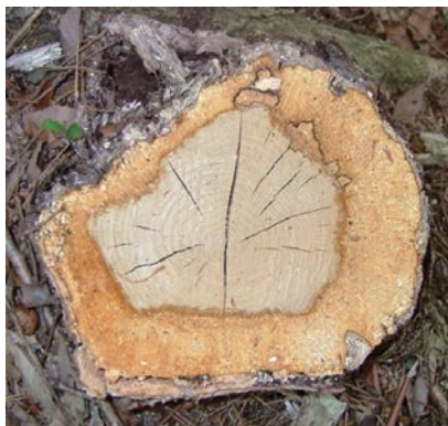
写真1-1 辺材部分だけが腐った伐根部
