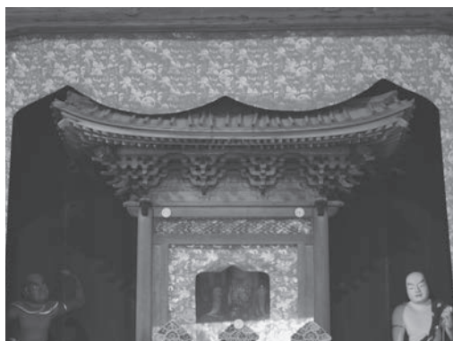
図12 宮殿、修理前 丸瓦型棒木が一部欠損
