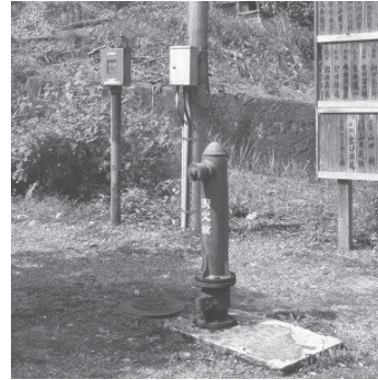
図4 発信機と消火栓
