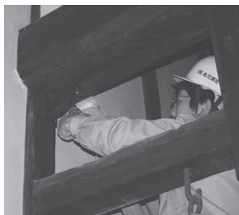
図17 通りニワの柱と梁の仕口に耐震リングを取り付けた状態
