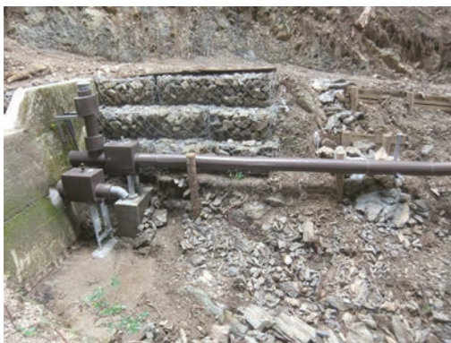
写真9 堰堤導水管、空気弁
