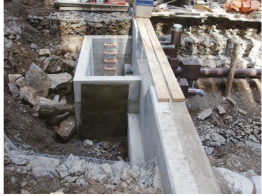
写真4 ピット通水マット
