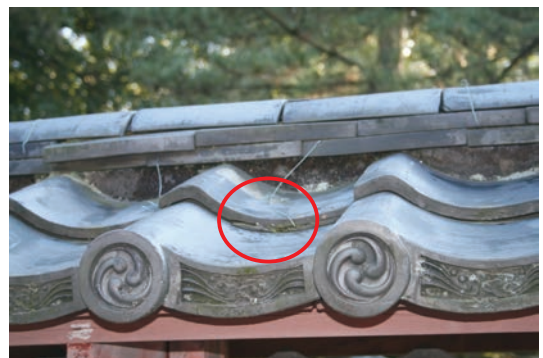
写真1 瓦底面の劣化(層状の剥離)
