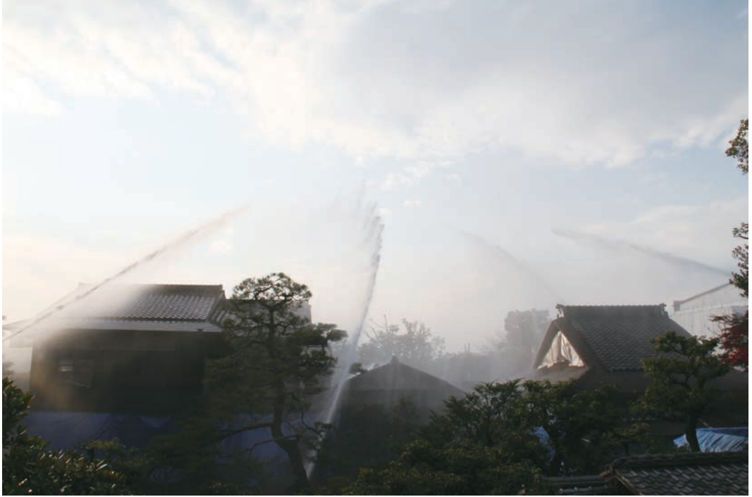
口絵3 伏見稲荷大社 御茶屋庭園 放水（放水銃4基）
