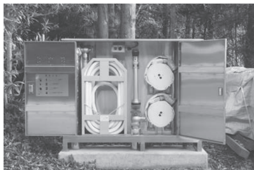
写真-14 ユニット型消火栓（内観）
