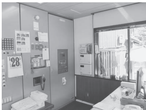
写真-9 R型受信機及びモニター（改修後）
