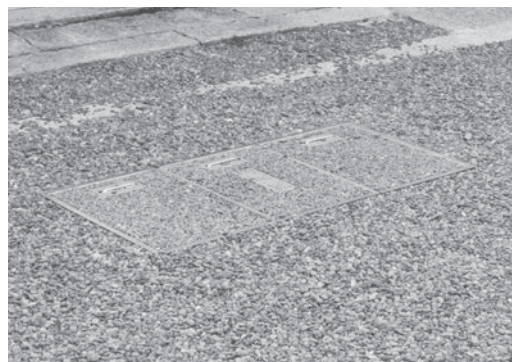
写真-28 地下式起倒放水銃蓋
