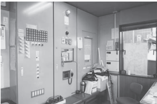
写真－5 警衛所内自火報受信機（改修前） 右端の盤が受信機P型1級100回線
