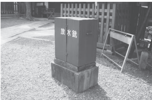
写真－7 境内放水銃（改修前） 格納箱の土台が木製になっている
