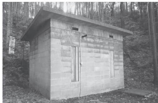
写真－8 取水ポンプ室（改修前） 窓ガラスが割れ、木板を打ち付けてある
