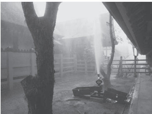
第一本殿柵内の自動首振式放水銃
