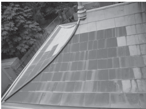
写真 3.1 玄関ポーチ金属板(銅板)屋根の腐食状況
