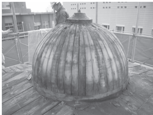
写真 3.2 換気塔野地の腐食状況
