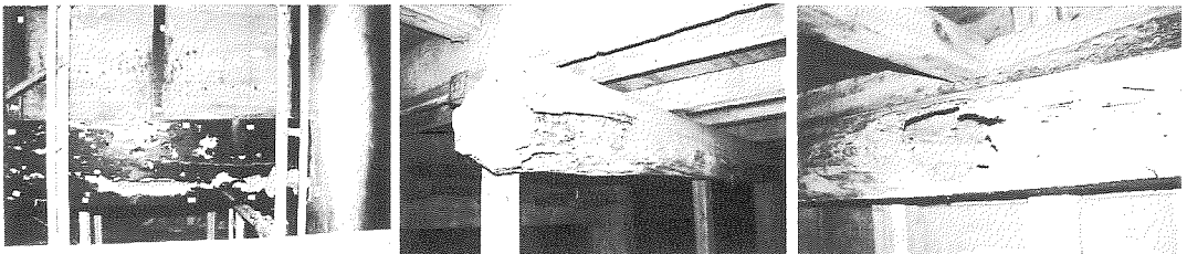
図6 建物内でヤマトシロアリの被害が飛び火的に拡大し、来迎壁にまで被害が及んだ例（富山県の寺院）
