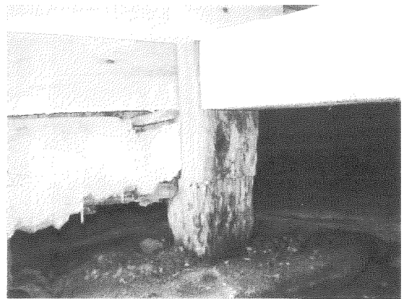
図5 長年放置された柱下部の腐朽（京都市内の寺院）
