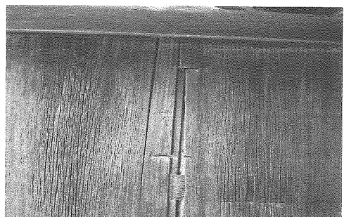
図5 玄関廊正面建具の戸板 風食により相釘が浮き出していた。
