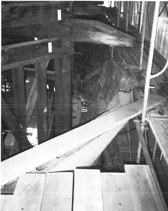
写真-2 阪神淡路大震災後の移情閣3階コンクリートブロックが倒壊し、外部足場に寄りかかる
