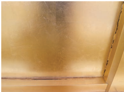
図7 第二層軒裏 隅が切れ、表面にひびが生じている
