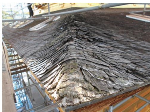
図4 第二層屋根北西隅の詳細 柿の傷みが著しい
