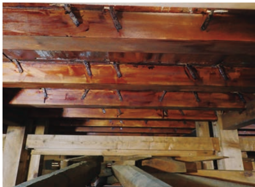
図13 第二層小屋裏内 昭和61年に取り替えた第三層の床板と下地は裏面も拭き漆が施されていた
