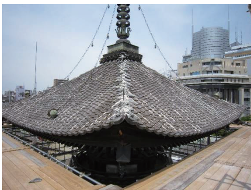
図5 修理前、上層、隅棟積撤去後 隅棟の宝珠が外れ、水煙が一部欠失していた。 隅棟積は肌熨斗が少し残るのみで、大半が 飛ばされていた。
