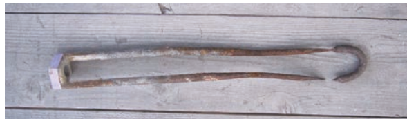
図12 宝珠止め金具、破損状況 南蛮漆喰から出ている部分で鋼棒が細くなっており、台風により切断に至った。図15と比較すると、金属棒の先端付近が、著しく細くなっていることが分かる。
