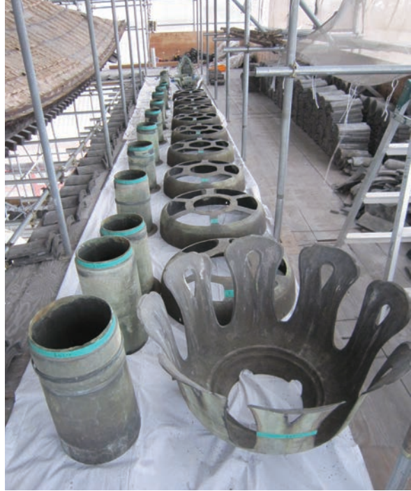
図10 相輪金物、解体状況修理前 錆が発生している。
