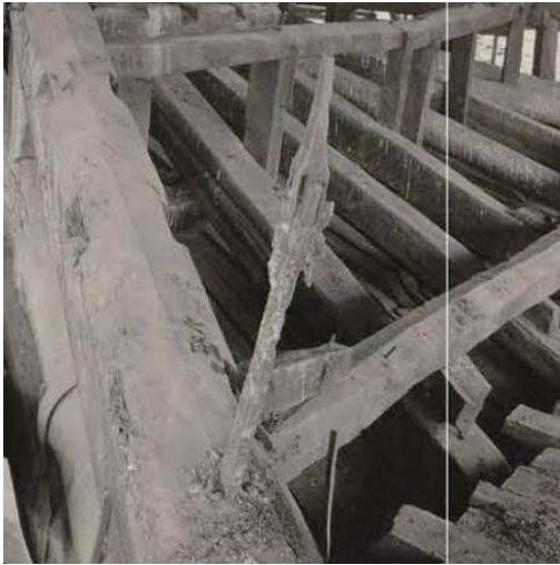
図14 昭和11年、工事写真 宝珠止め金具修理後前 2本の金属棒を栓で繋いでいるように見える。 今回の台風同様、先端が切断されている。
