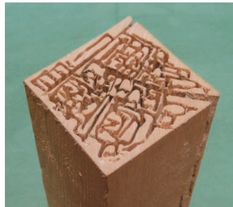
写真15-11 イエシロアリによる被害材
