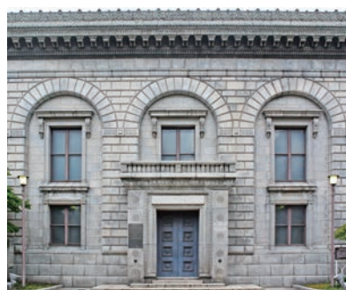
図7 旧三井銀行小樽支店（昭和2年、曾禰中條建築事務所、重要文化財）立面詳細
