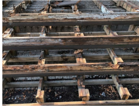
写真13-5 屋外階段の下地材の腐朽 (下段の木材は褐色腐朽、中段の木材に 白色状の腐朽菌糸らしきものが見える)
