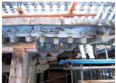
図8 積雪被害 （正面軒先、補強桁の外側で茅負が折れる）
