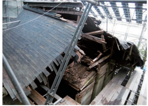
図4 破損状況 背面側
