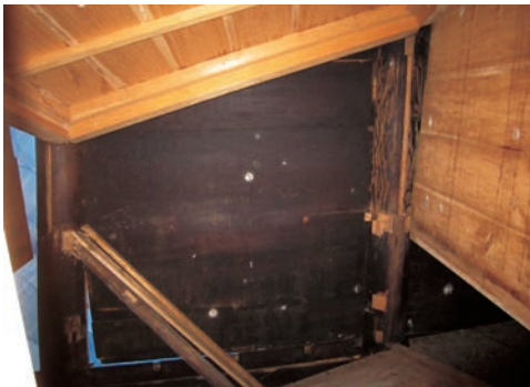
図5 破損状況 内陣（天井、床が外れている。）
