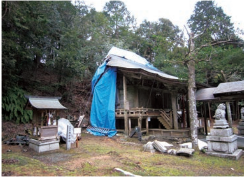
図3 破損状況 全景
