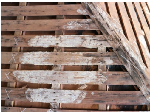
図10 柿解体後 雨漏りによる野地の腐朽状況
