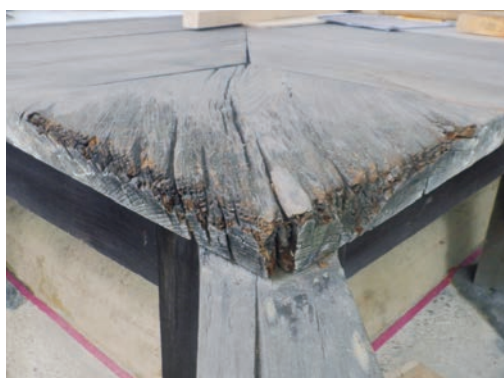
図6 縁全体に傍の隙間が広がり、 小口割れや腐朽、小口塗の剥離が目立つ
