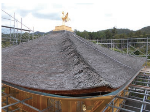
図3 第三層屋根南東 柿の隅周辺の傷みが著しい
