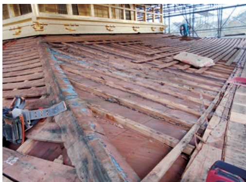
図11 腐朽野地板を解体後 野垂木間に捨て銅板がある
