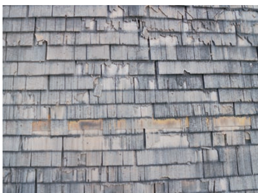
図5 平葺状況 控えて入れた葺込銅板が露出している
