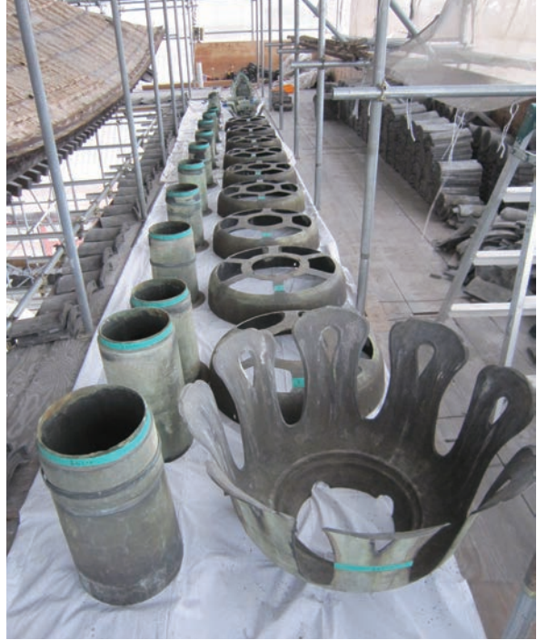
図10 相輪金物、解体状況修理前 錆が発生している。
