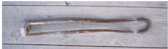
図12 宝珠止め金具、破損状況 南蛮漆喰から出ている部分で鋼棒が細くなっており、 台風により切断に至った。図15と比較すると、金 属棒の先端付近が、著しく細くなっていることが 分かる。
