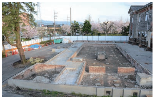
写真8 修理前煉瓦基礎
