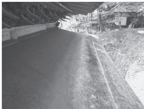
図7 裳階こけら葺、雨落ちより外のみ劣化
