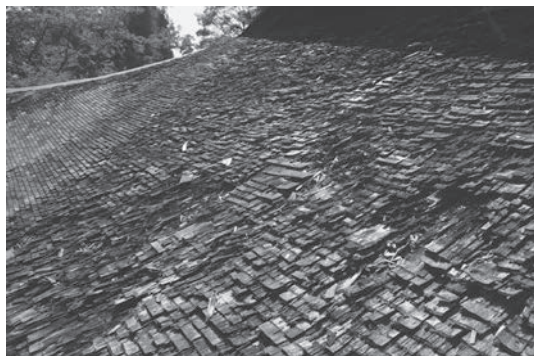
図6 身舎こけら葺破損状況
