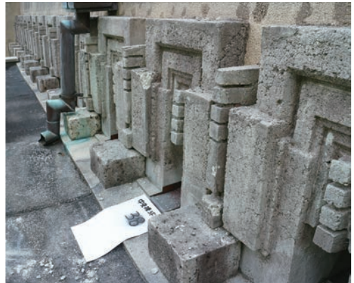
3階和室底上 擬石飾りAタイプ状況 表面劣化や欠損が見られる
