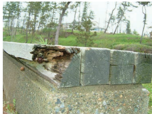
写真1-2 外構施設に利用されていたヒバの部材（辺材を含んでいた部材ではその部分だけが腐朽）
