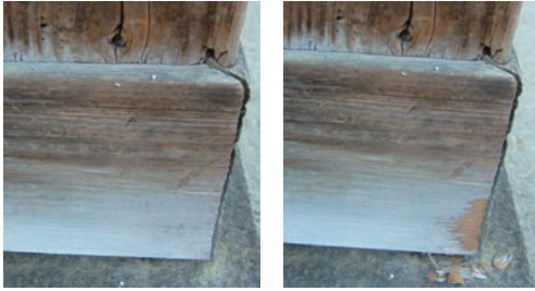
写真4-2 白化した木材表面を削ったところ
