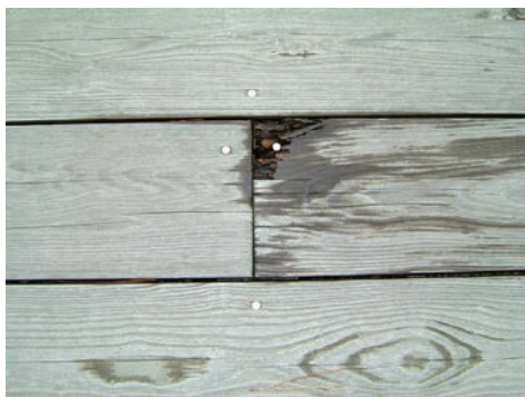
写真3-4 デッキ材での木口部分からの腐朽の進行
