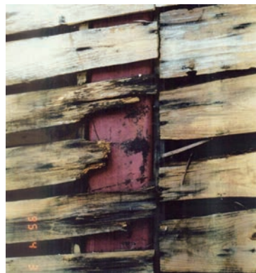
写真3-5 金属との接触部での木材の腐朽
