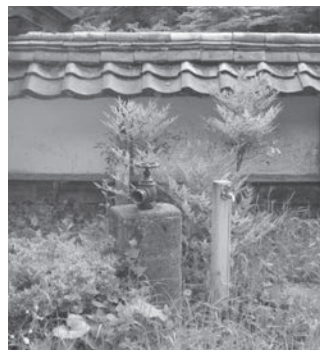
図6 消火栓（庫裡前）
