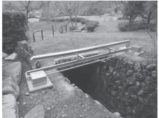
図28 配管架橋 庫裏の消火栓用送水管・電路
