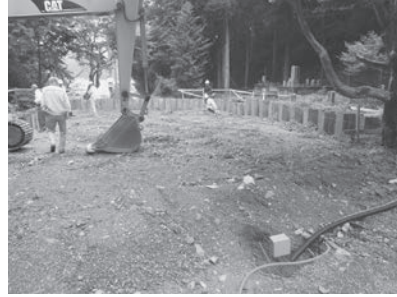
図20 電気設備・鋼矢板
