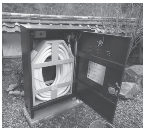
図17 屋外消火栓（庫裡） 内部起動釦・ホース
