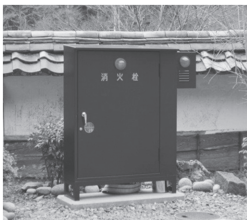
図16 屋外消火栓（庫裡） 一括異常通報表示盤付
