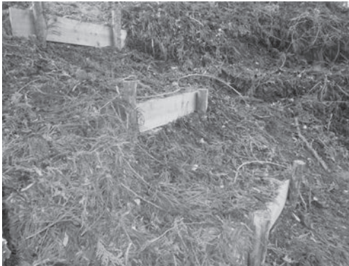
図27 崩落防止板柵
