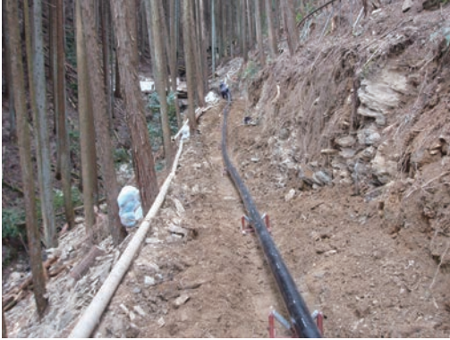
写真3 ポリエチレン管
