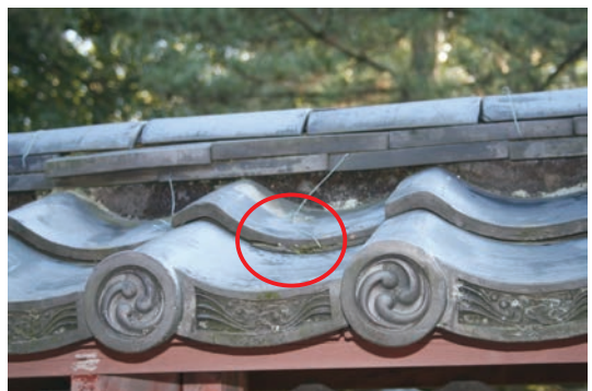
写真1 瓦底面の劣化(層状の剥離)
