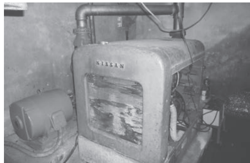
写真-6 取水用エンジンポンプ（改修前） 今では滅多に見ることの出来ない日産製エンジン
