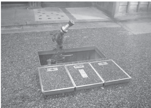
写真-27 地下式起倒放水銃
