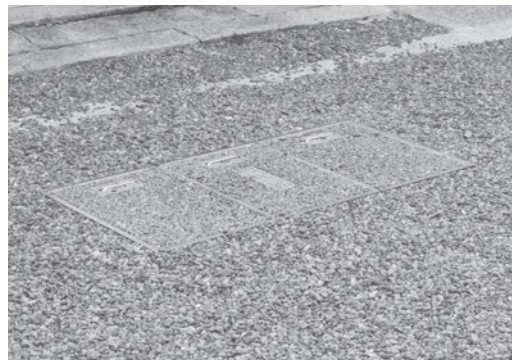
写真-28 地下式起倒放水銃蓋
