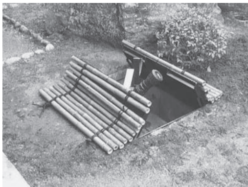
写真-21 地下式放水銃が上昇
