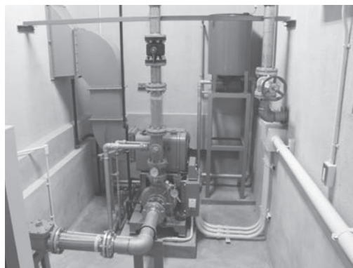
写真-10 取水用エンジンポンプ（改修後）
