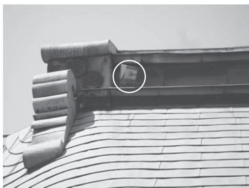
写真-11 三波長炎感知器（内拝殿大棟）
