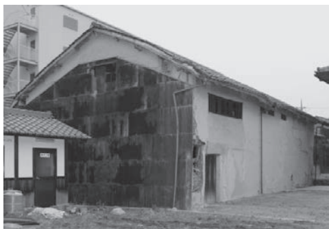
図6 修理前 物入2 南西面
