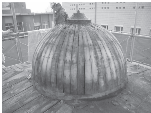
写真 3.2 換気塔野地の腐食状況
