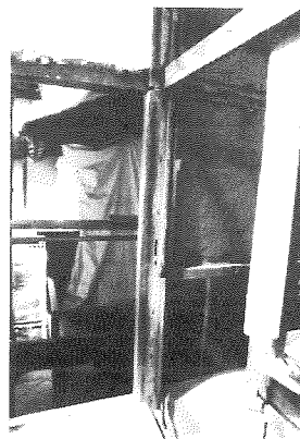
写真9 仏壇北東柱南面 解体前は貼り壁であったが、土壁の痕跡が見られた
