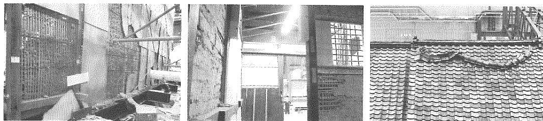
外壁土壁の損傷
