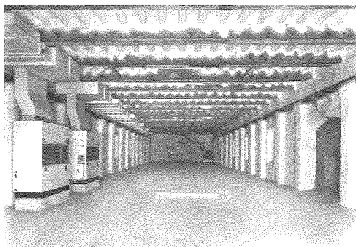
写1 修理前の状況
