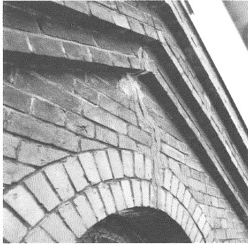
写3 レンガ壁クラック
