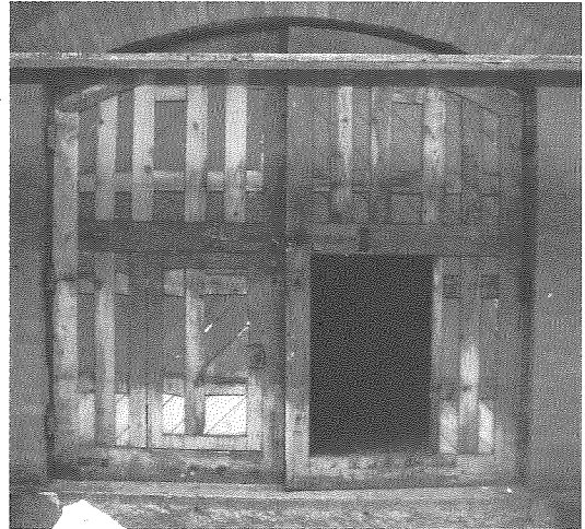
写4 扉破損状況
