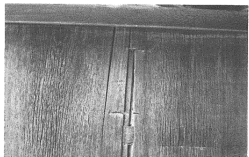
図5 玄関廊正面建具の戸板 風食により相釘が浮き出していた。
