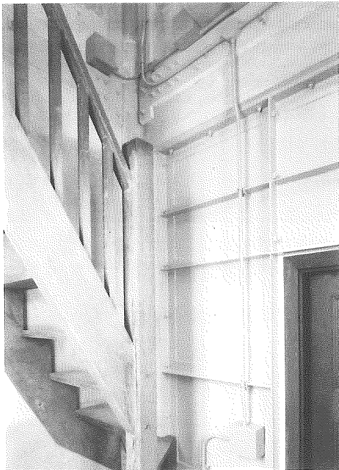
写真-4 2階塔屋内部 南西面を見る 鉄骨の構造補強材が判る
