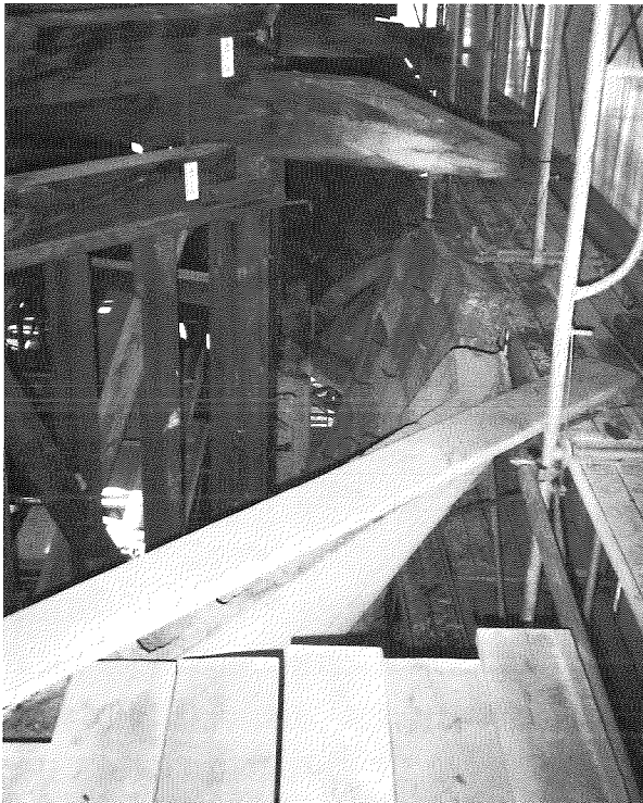
写真-2 阪神淡路大震災後の移情閣3階コンクリートブロックが倒壊し、外部足場に寄りかかる
