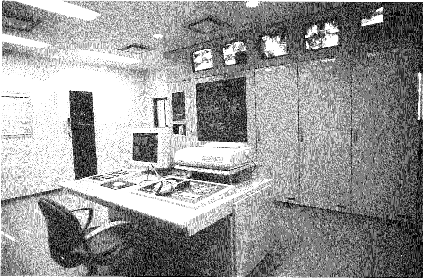
写真-1 防災盤配置
