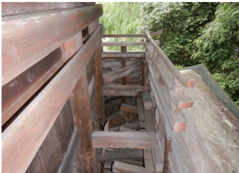
図6 修理前 2層縁 高欄内側に縁板はないが、 外側には木口のみ縁板がつく。
