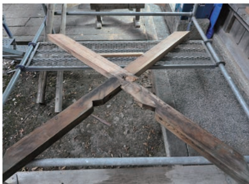
図6 千木腐蝕状況 右下部材が交差部で折損している
