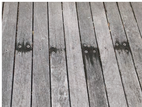
写真15-8 デッキ材のつなぎ目の木口から浸入し滞留した雨水
